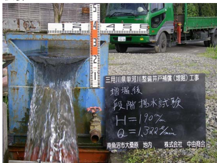
揚水量の増加確認
